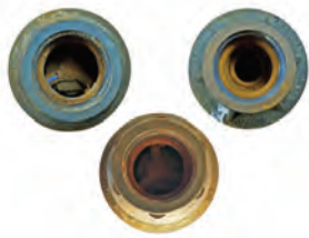
الداخل والخارج لمنظمات الضغط المتآكلة
