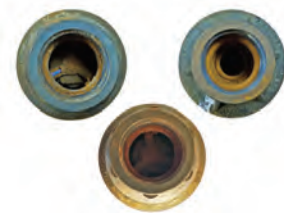
Entrada y salida de los reguladores de presión desgastados.
